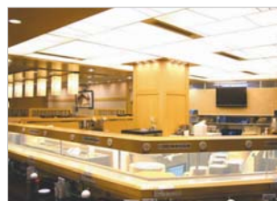
「P'es Lighting」 LED照明器具施工例
